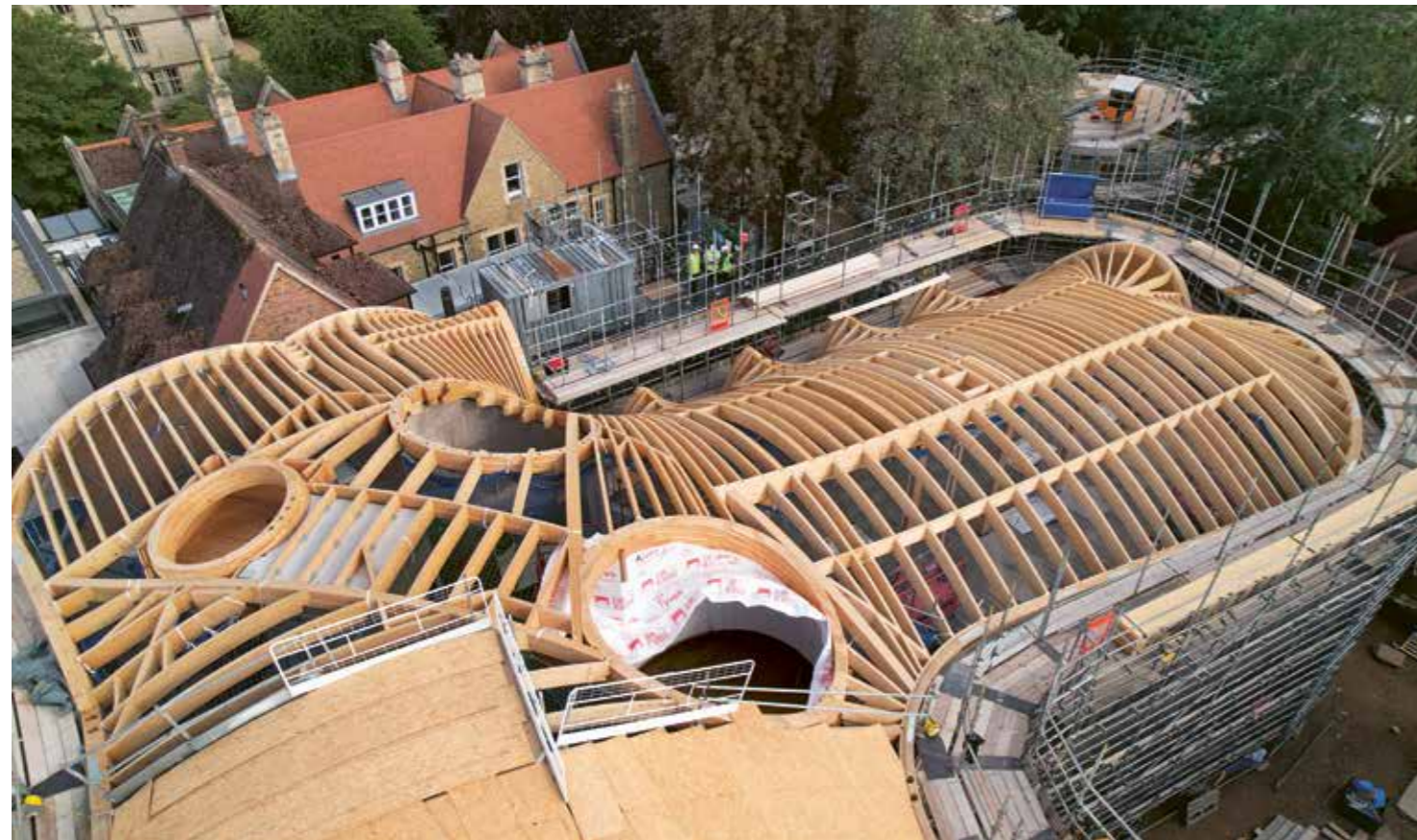
La solution créative pour le toit consiste en une forme libre avec une structure porteuse en bois et permet d'économiser de l'énergie grise.
