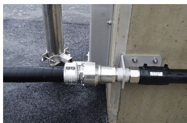
Abzugsstutzen der Soleanlage
