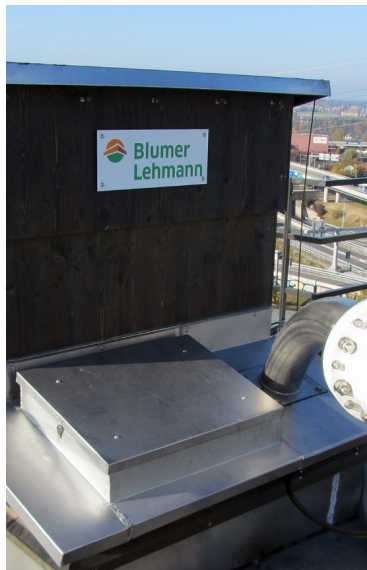
installation de silos à sel avec véhicules d'épandage à Berne Wankdorf
